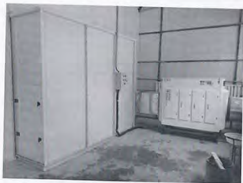
干式过滤棉+活性炭纤维+光氧催化装置
