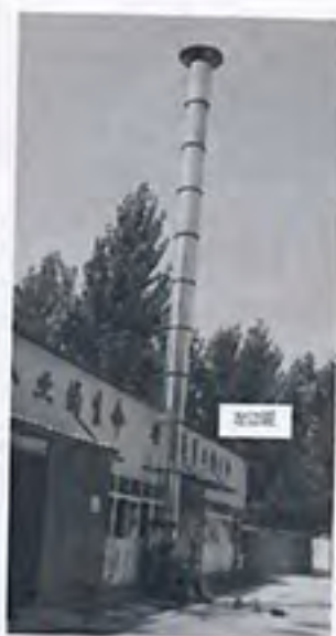
喷漆、晾干工序废气排气筒
